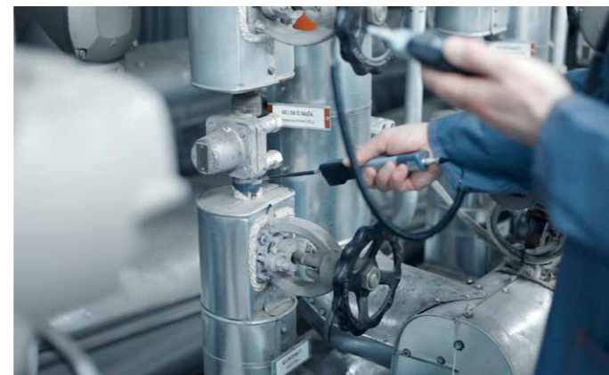
Temperaturmessung mit SONAPHONE an einem Kondensatableiter
